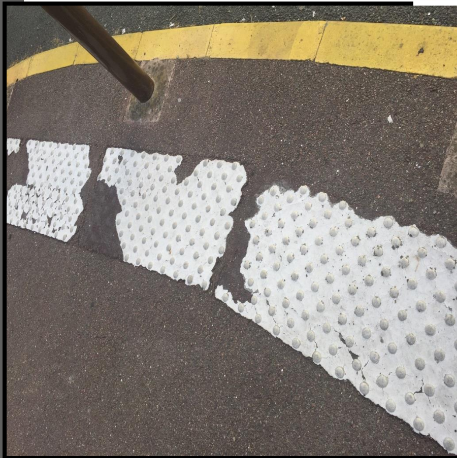
Passage piéton pk Jacob bande podotactile dégradée bis
