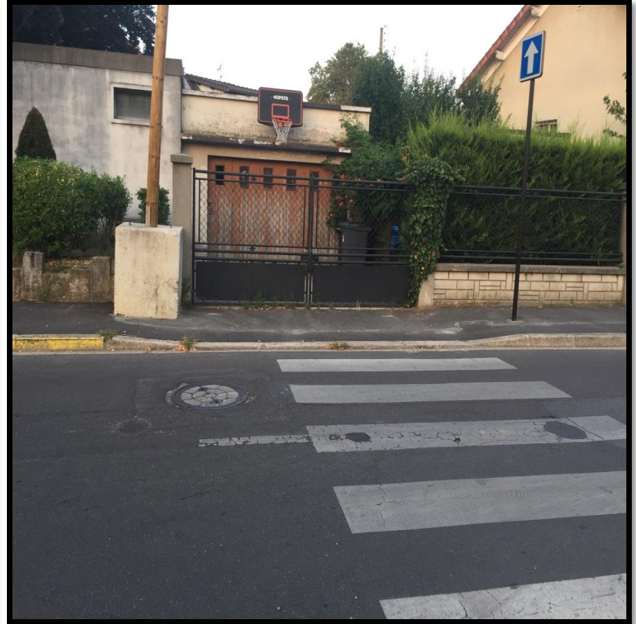
Potelets passage piéton manquants
